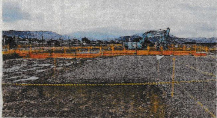
工事が本格化する亀岡市亀岡駅北土地区画整理事業の対象エリア(亀岡市追分町)
